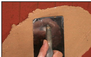
Étape 1 - application directe sur brique plâtrière légèrement humidifiée (pas de sous couche de fond ou d'accroche)
